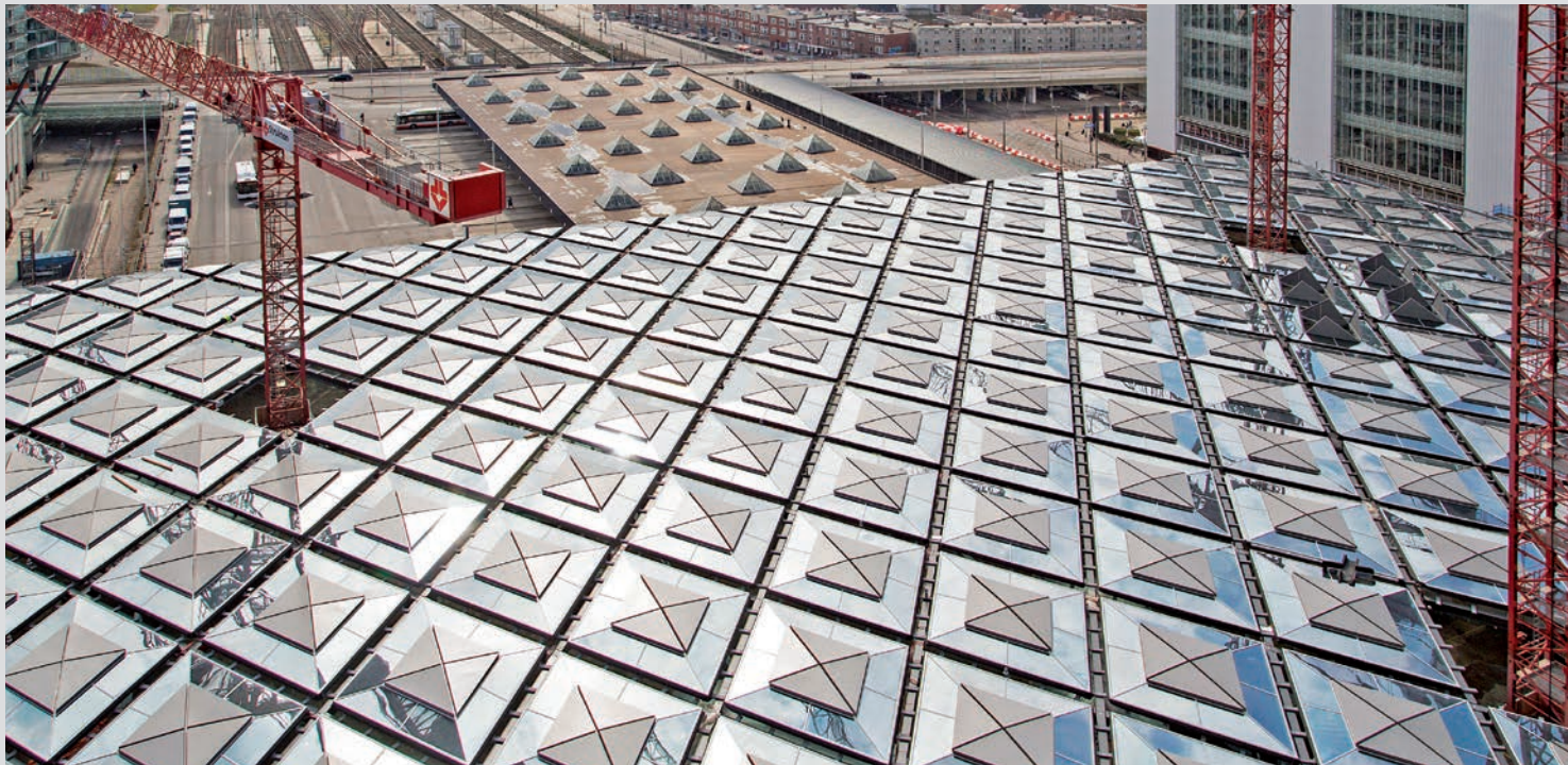
Insgesamt 956 Einheiten des RWA-Systems Firelight wurden beim Zentralbahnhof Den Haag verbaut
