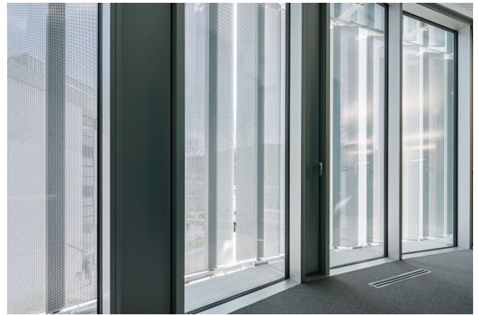
Bild 3. Aufgrund der Helligkeitssteuerung haben die Mitarbeiter stets optimale Lichtverhältnisse in ihren Büros
